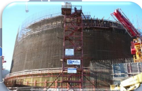
Ленинградская АЭС-2, эб. №1-2 (2,4 ГВт, 2015, 2017)
