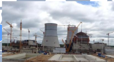
Нововоронежская АЭС-2, эб. №1-2 (2,4 ГВт, 2015, 2016)
