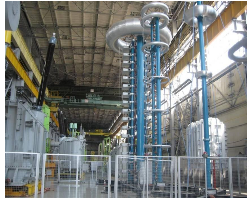
Испытательные поля цеха высоковольтных испытаний
