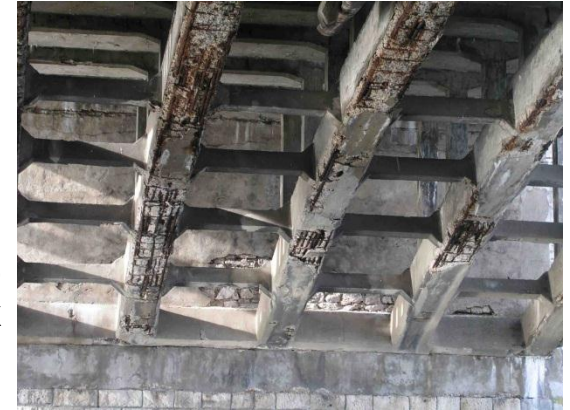
Рисунок 12. Разрушение опор моста
