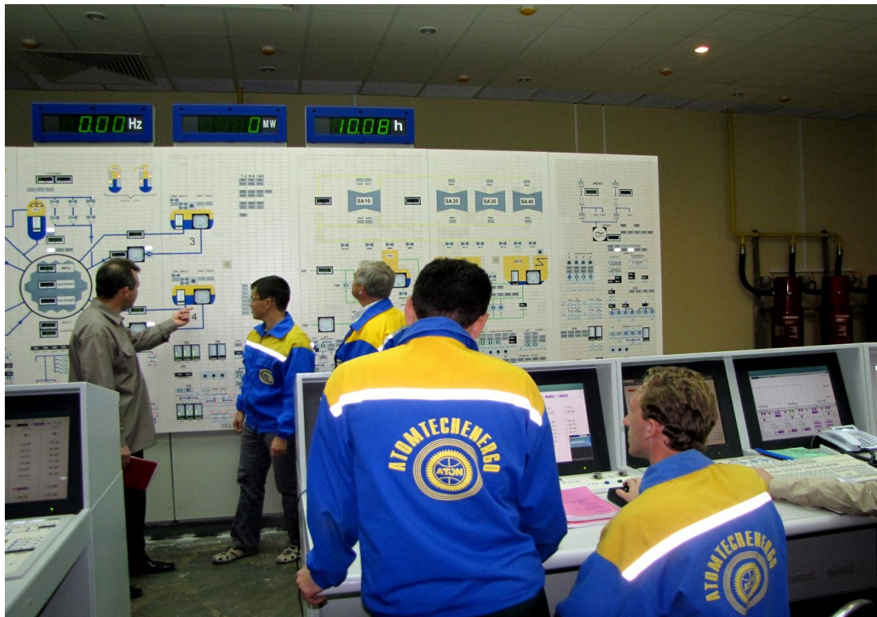
Рис.3 Выполнение проверок АСУ ТП АЭС «Бушер»
